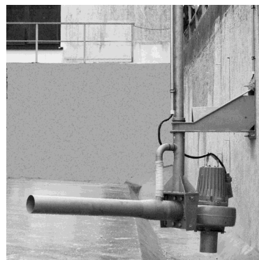
Monteret i afløbsrende af rektangulært bassin
